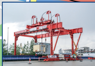
Schwergut-Umschlagplatz mit Ro-Ro-Rampe und Litzenhubsystem
